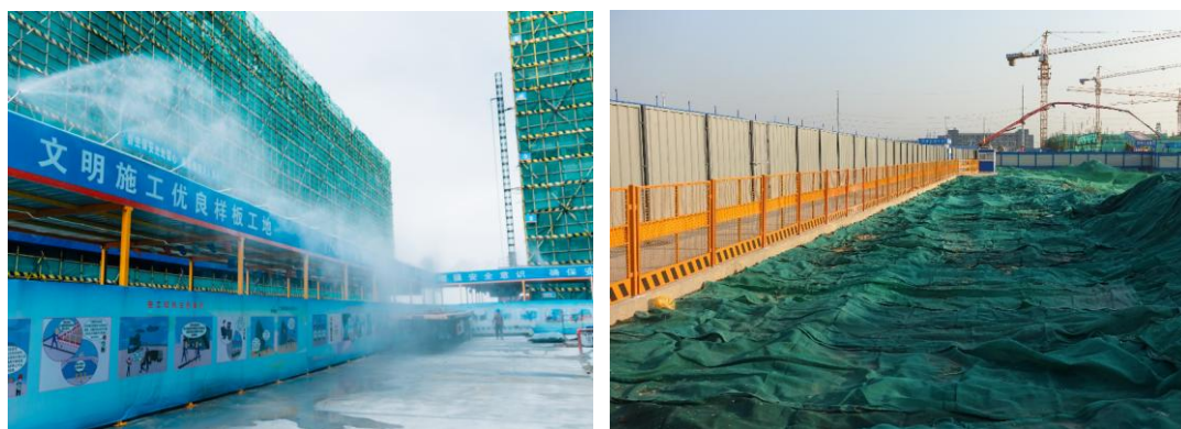
施工场地配备喷淋设备，对于非施工地段的裸露土地实行百分百覆绿，确保防尘 6 个 100%目标达成。
