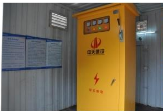
23. 标化配电柜防护
